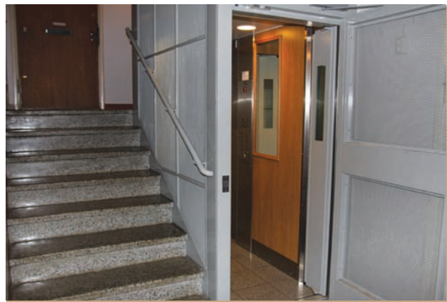
Hydraulihissien kanssa voidaan käyttää kevyttä verkkokuilua. Kuvassa Haagaan asennettu Amsliftin kaitahissi.
